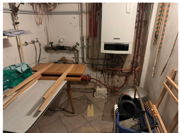
KG Heizungsraum, Gaußstr. 21, 50767 Köln
