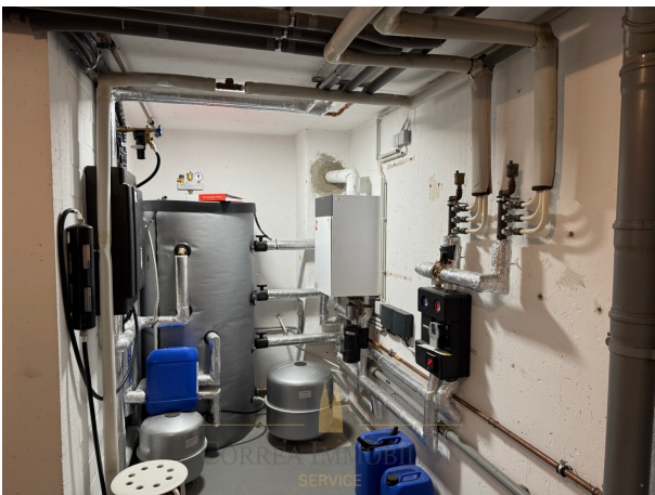
KG Heizungsraum, Fröbelstr. 68, 50767 Köln
