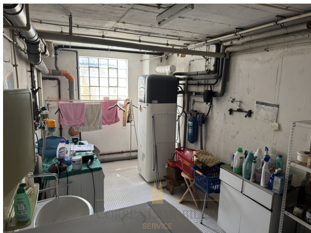
Waschkeller mit Heizungsanlage
